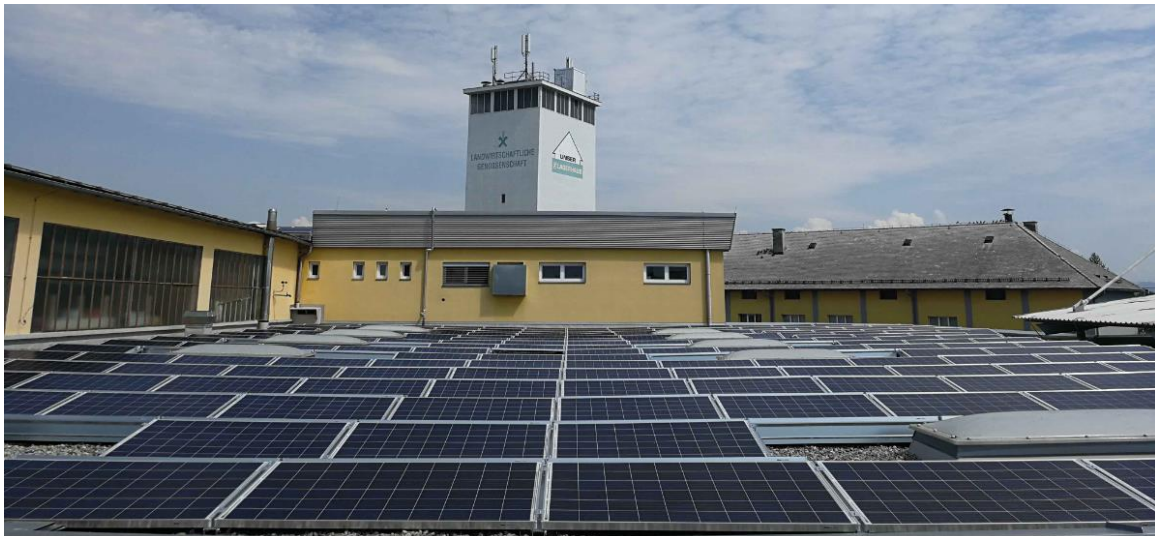
PV Stahlbau Lex Gratkom
